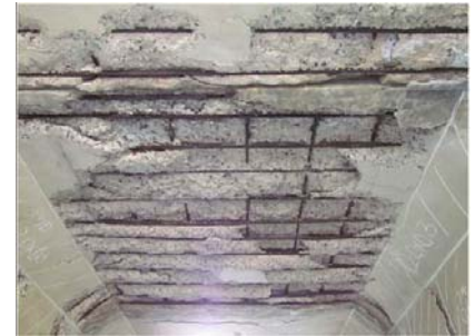
写真-2 頂版の鉄筋露出状況
