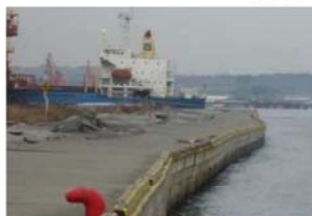
被災事例(はらみ出し)
