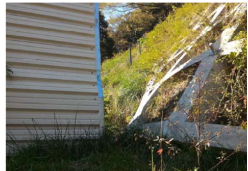
写真-2 動物侵入箇所 (道路切盛り境)
