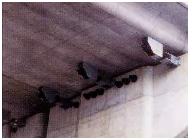
PC 鋼棒タイプの落橋防止装置
