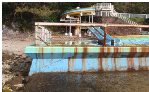
写真-1 既設フェンス損傷状況
