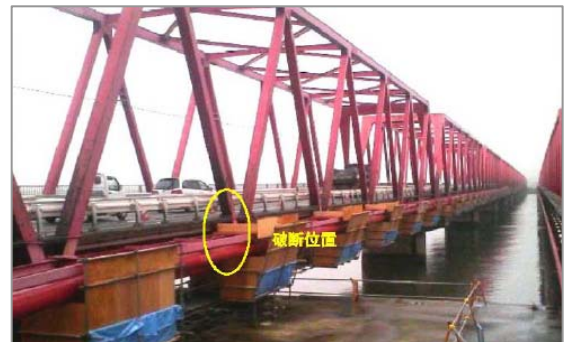
図-2 橋梁の破損事例
