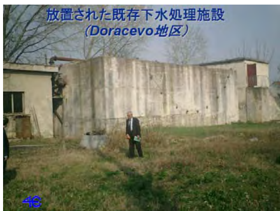
図-4 放置下水処理施設
