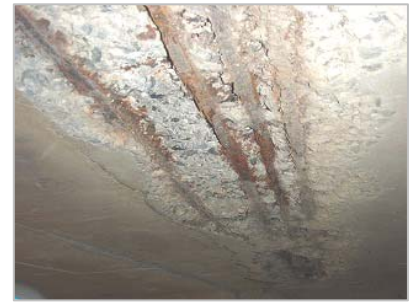
写真-1 鉄筋露出状況
