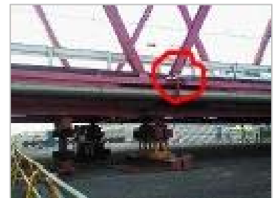
図-2 鋼橋の疲労破壊例
